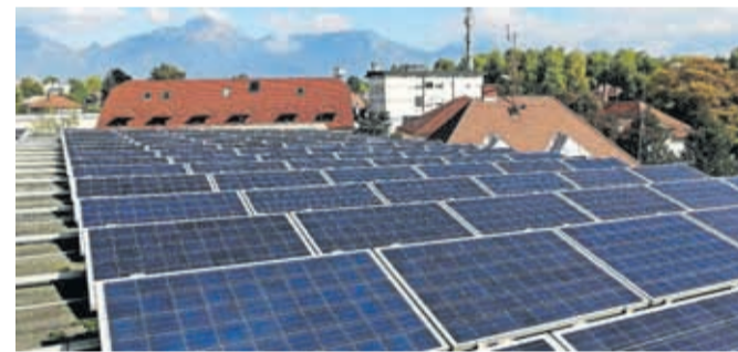
Sončna elektrarna na strehi Mestne občine Kranj
